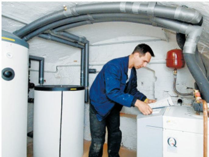
Erdreich-Wärmepumpe: Wer jetzt eine effiziente umweltfreundliche Heizungsanlage installiert, kann dafür zinsgünstige Kredite der KfW in Anspruch nehmen. FOTO: DPA
