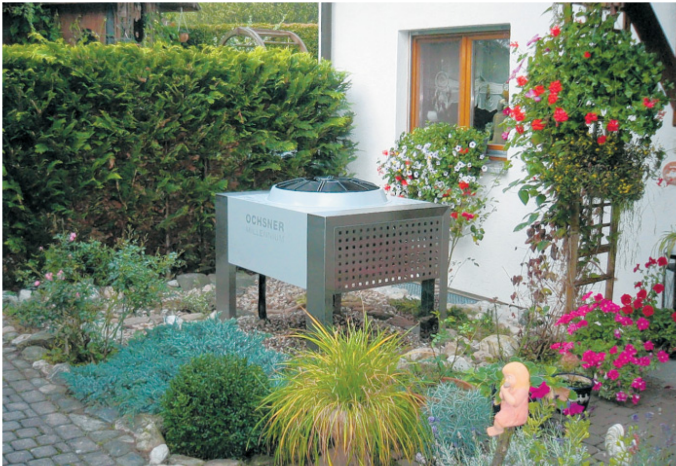
So kann man künftig die schwankenden Stromtarife zum Sparen nutzen: Heizwärme und warmes Wasser mit der Wärmepumpe erzeugen und in einem Pufferspeicher speichern. FOTO: DJD
