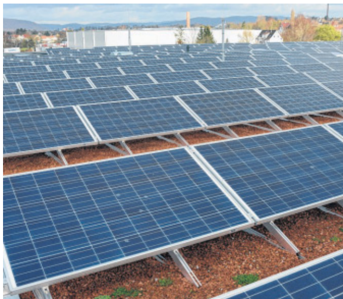
Stromerzeugung: Die Photovoltaikanlage auf dem Dach.
