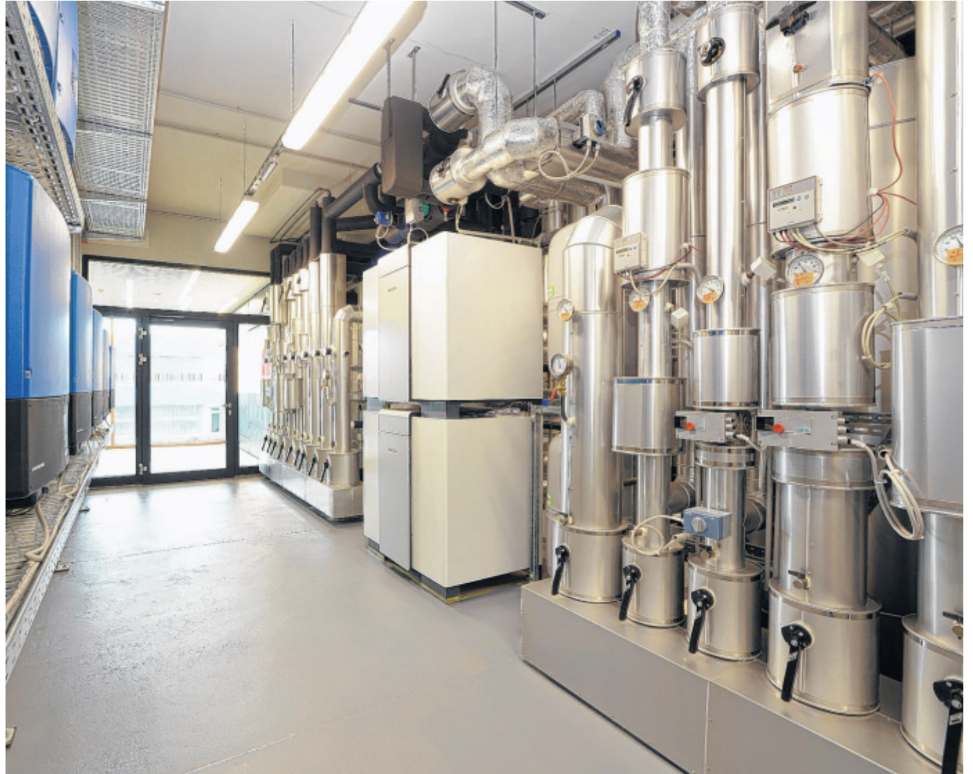
Das Herz des Energy Campus: Der Blick in die Technikzentrale mit den beiden Groß-Wärmepumpen für Heizung und Kühlung des Gebäudes.
