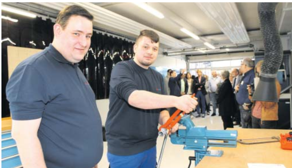
Lerninsel: Der angehende Anlage-Mechaniker Philipp Lemmens (r.) baut unter der Aufsicht von Ausbilder Christian Zierz eine Kaltwasserleitung in der neuen Heinrichs Werkstatt von Gebrüder Becker in Höxter zusammen.
