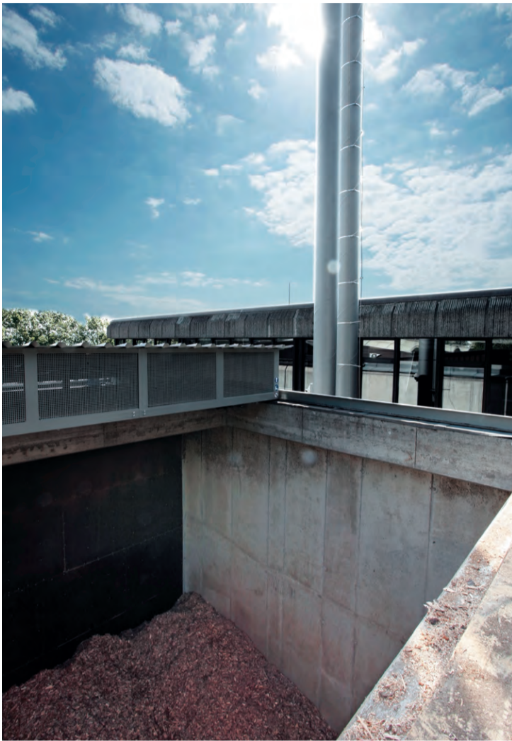
Holzackschnitzelbunker und Abgassystem
