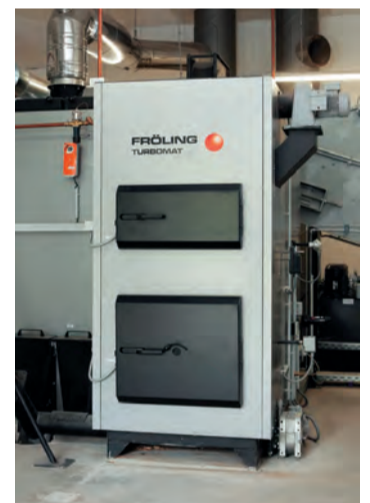
Hackschnitzelkessel mit Kratzkettenförderung
