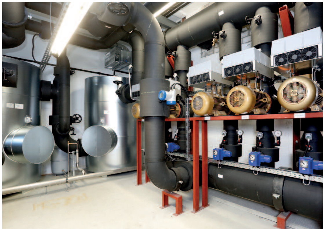
Verteileraufbau samt Pufferspeicher
