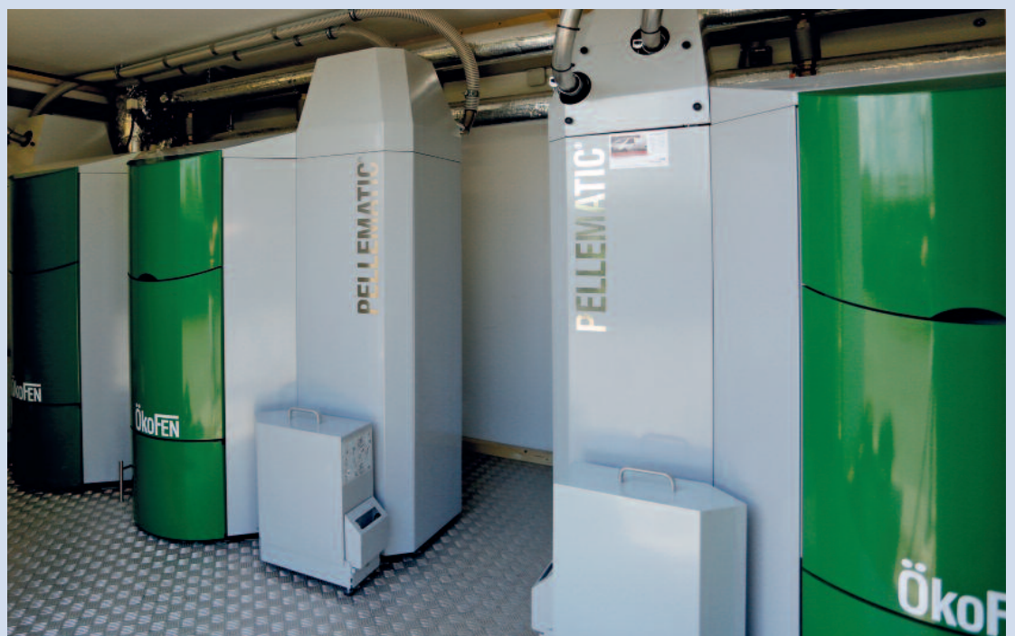
Heizzentrale mit 4 Pelletkesseln
