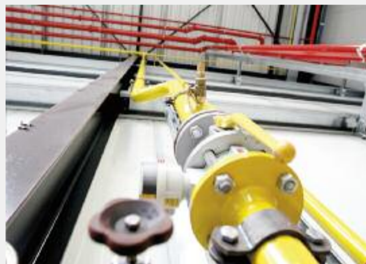
Gashauptleitung für Dunkelstrahler
