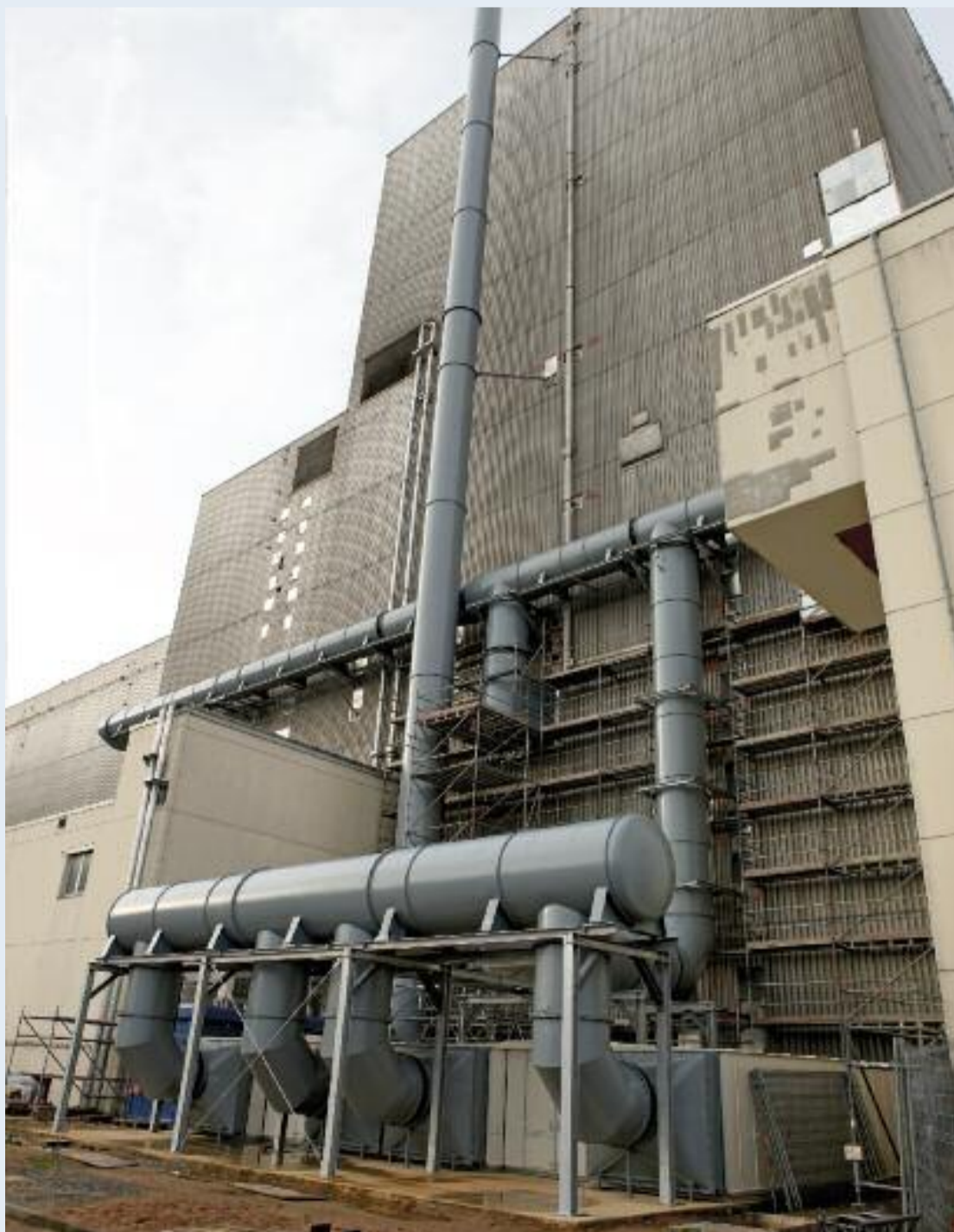
Gesamtabluftanlage bestehend aus vier Geräten
