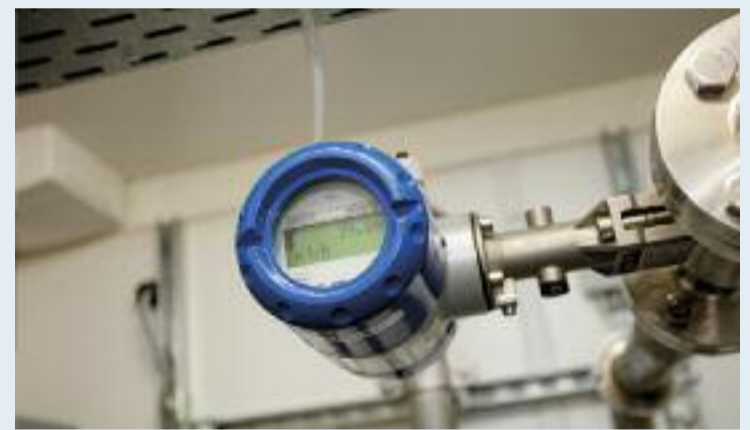
Volumenstrommessung der Abluft
