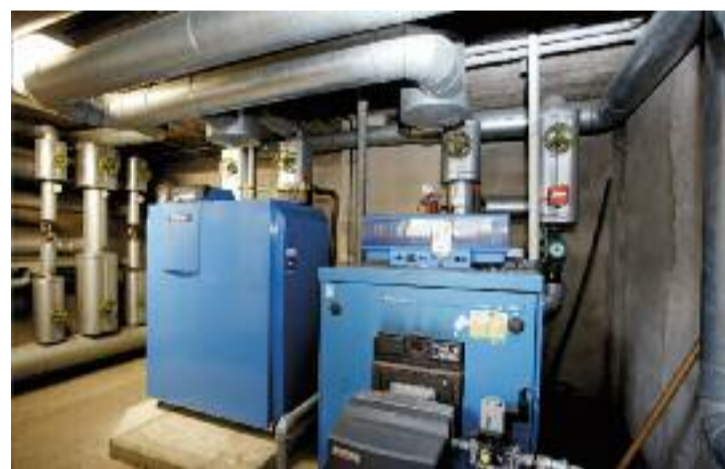
Kaskadenbetrieb des neuen und alten Kessels
