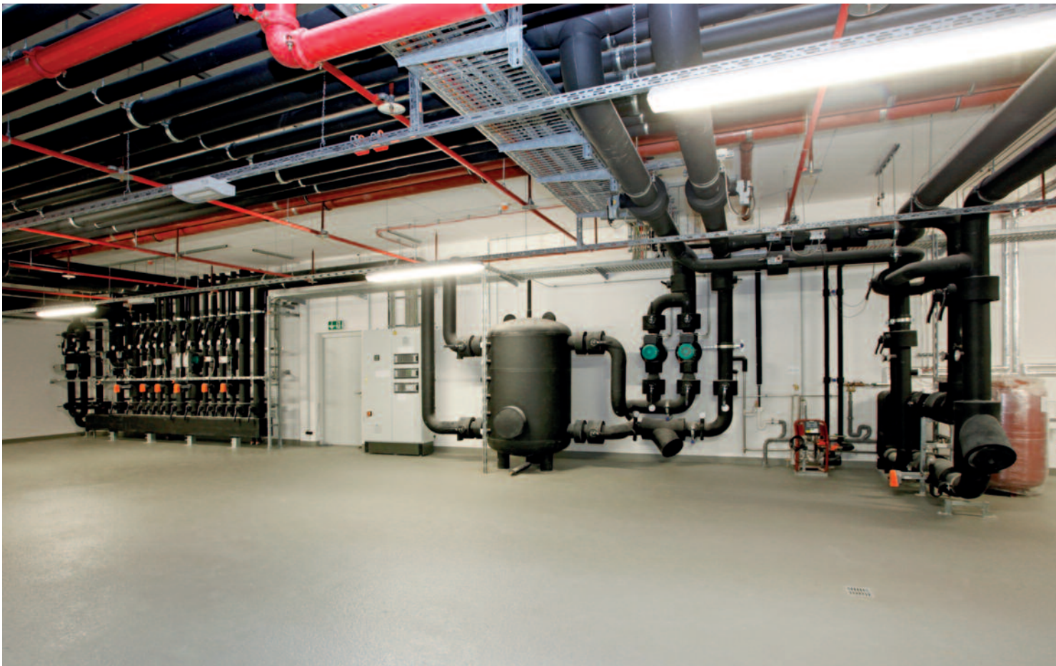
Blick in die Kältezentrale
